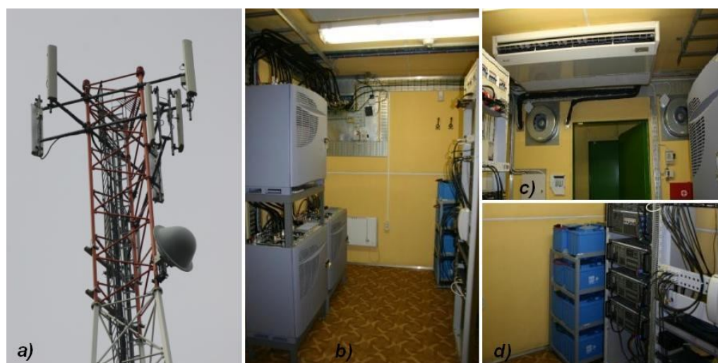
13 pav. a) Antenos GSM bokšte, b) trys bazinių stočių vidiniai moduliai, c) kondicionavimo įranga, d) nepertraukiamo maitinimo šaltinis
